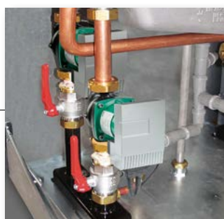
Pompe e saracinesche d'intercettazione idraulica
