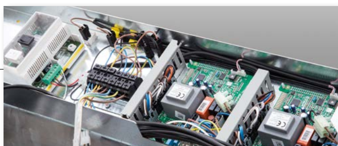
Complesso delle schede elettroniche di gestione degli elementi termici e BCM 2.0
