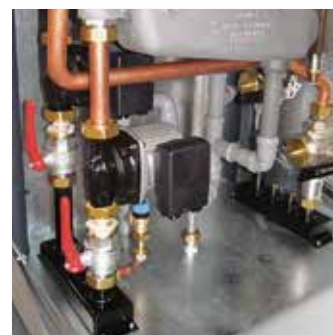
Szivattyúk és elzárók
